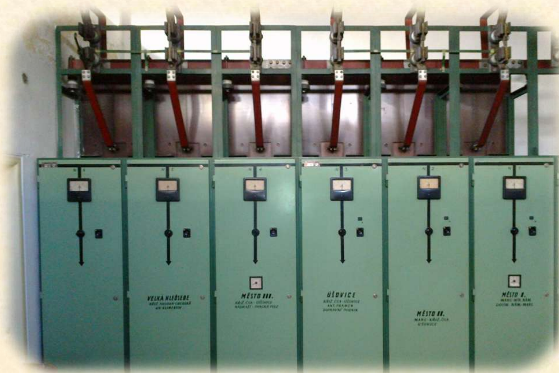
Vypínače napájecích úseků v současné měnárně.
